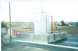
平成11年度国営土地改良施設整備事業で更新した 南方揚水機場屋外重油タンク
