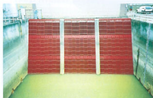
平成11年度国営土地改良施設整備事業で更新した 山吉田揚水機場吸水槽スクリーン
