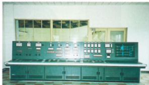
更新した米山揚水機場操作盤
