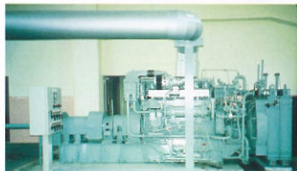
更新した南方揚水機場4号エンジン（260PS）
