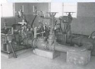
機械設備 横軸両吸込渦巻 ポンプ φ200mm 2台 モーター 11Kw 2台
