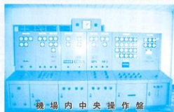
機 場 内 中 央 操 作 盤
